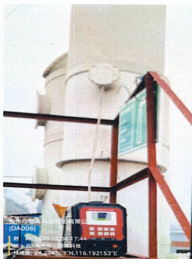
蚀刻废气排放口 DA006
