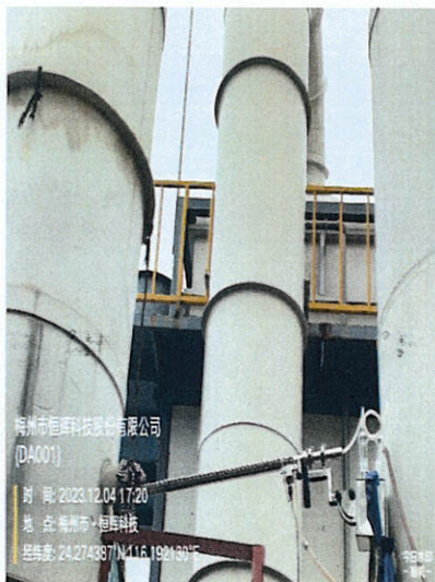
电镀废气排放口 DA001
