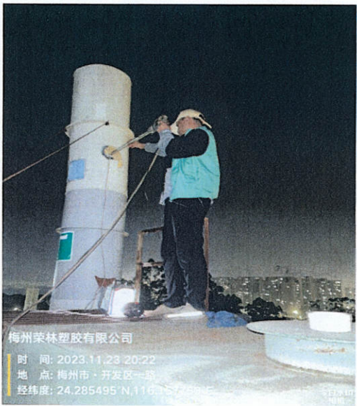
注塑废气排放口 DA001
