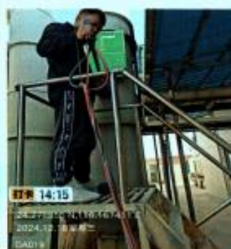
DA019 废气处理后采样口
