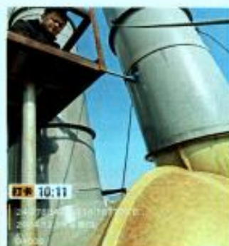
DA009 废气处理后采样口
