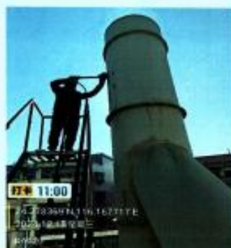
DA020 废气处理后采样口
