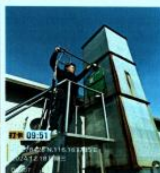
DA007 废气处理后采样口
