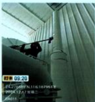
DA011 废气处理后采样口
