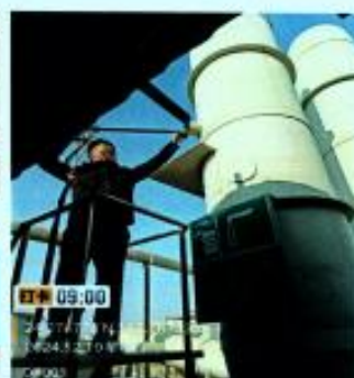
DA003 废气处理后采样口
