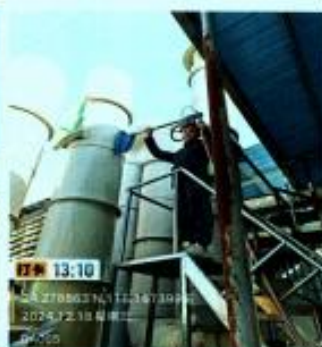
DA005 废气处理后采样口
