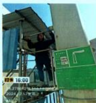
DA018 废气处理后采样口
