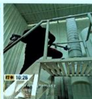
DA010 废气处理后采样口
