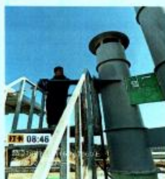
DA021 废气处理后采样口
