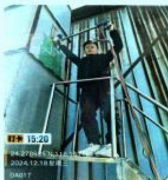
DA017 废气处理后采样口
