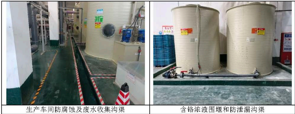
图 7.2-3 厂区事故废水风险防范措施现场照片
